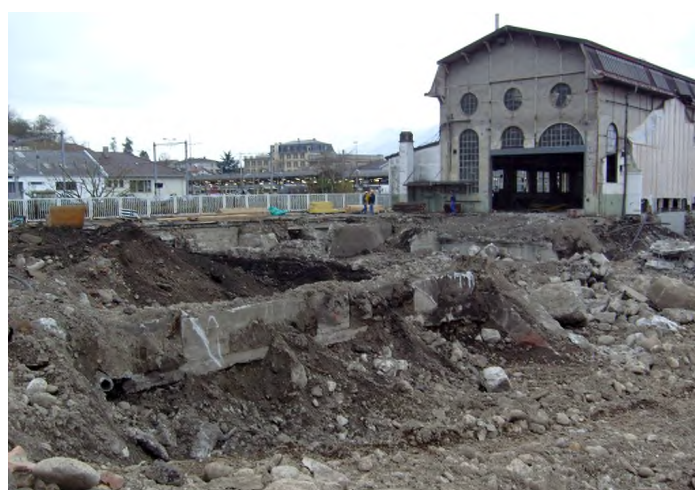
Remblais avec de nombreuses fondations enterrées
