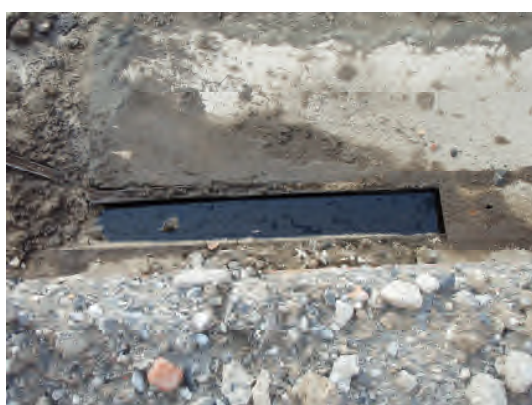
Fosse remplie d'huile découverte en cours de terrassement
